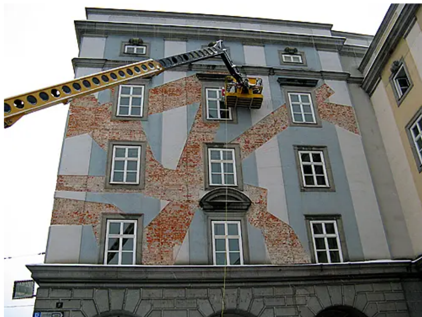
Was ist unter dem Putz? Roderich Ficks Brückenkopfgebäude in Linz, mit Installation von Hito Steyerl, 2009 (Bild: cc)
